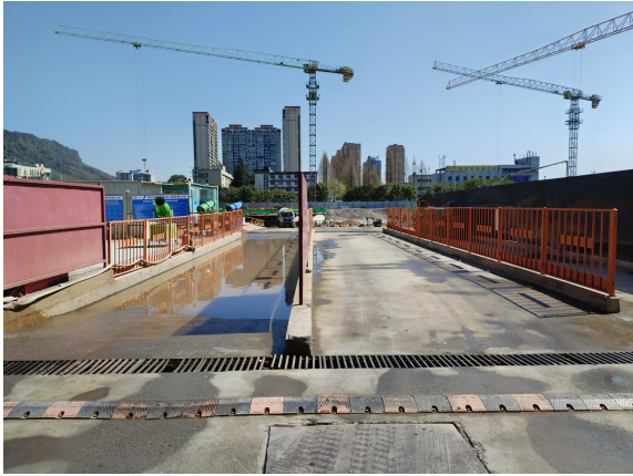
项目排水沟及洗车设施
